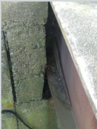
Mauvaise aération de la zone d'about et rétention d'eau
