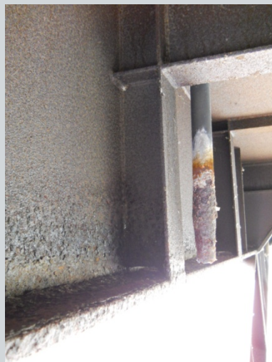
Mauvaise évacuation des eaux
