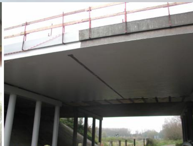
Mise en œuvre du revêtement de protection en intrados et sur appuis
